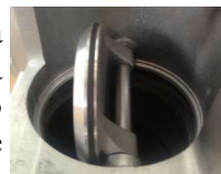
Válvula aberta totalmente
